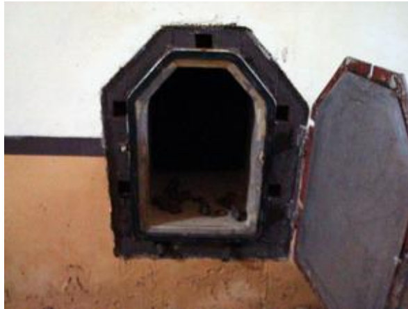
Figura 19 Interior de bodega. Las tapas de piletas de reducidas dimensiones provocan dificultades para el acceso de los operarios
