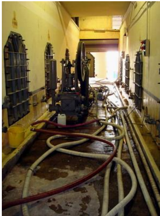
Figura 18 Interior de bodega. Mangueras sueltas y líquidos derramados en el piso del pasillo, representan una fuente de potenciales accidentes
